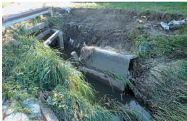
崩落した水路（現在は復旧済み）
