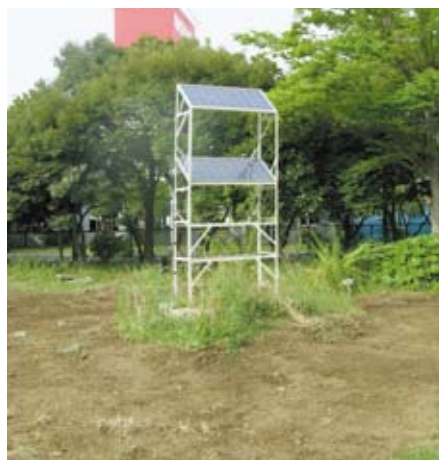
太陽光パネル
