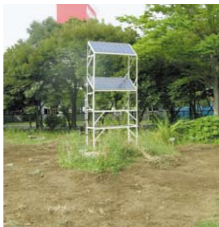
太陽光パネル
